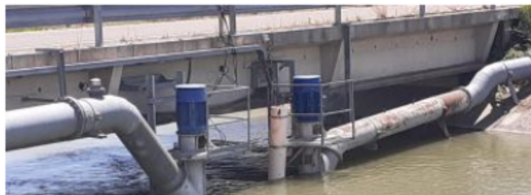
Impianti per l'irrigazione gestiti dal Consorzio di Bonifica
